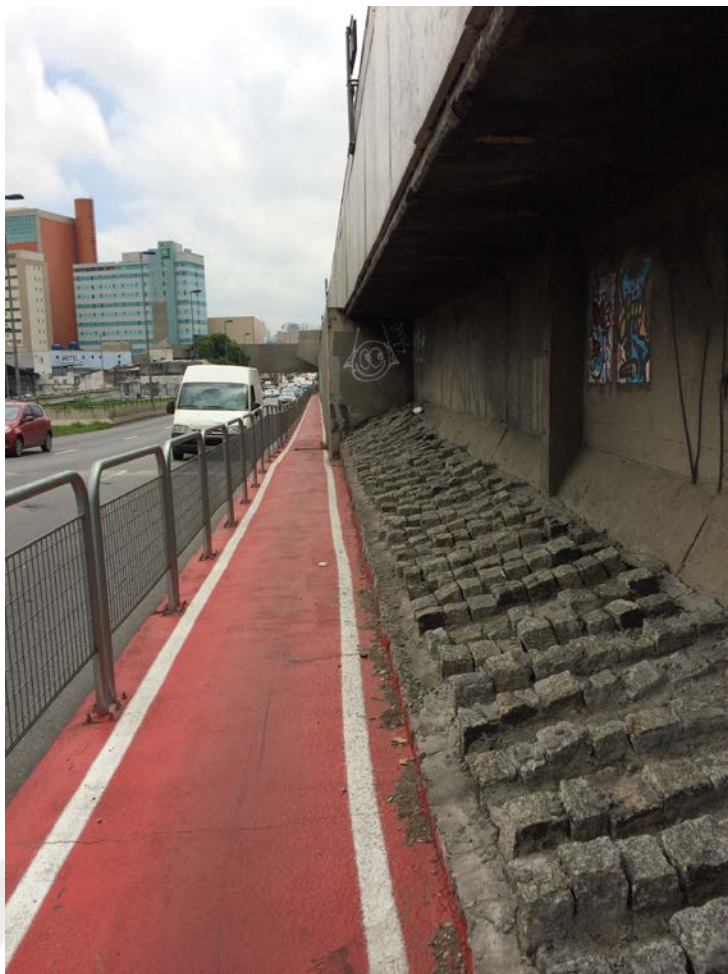
Área pouco iluminada e "sem saída"
