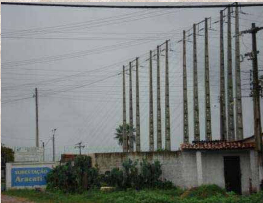
Sub-estação Aracati (a 20 km de Fazenda Praia Canoé)
