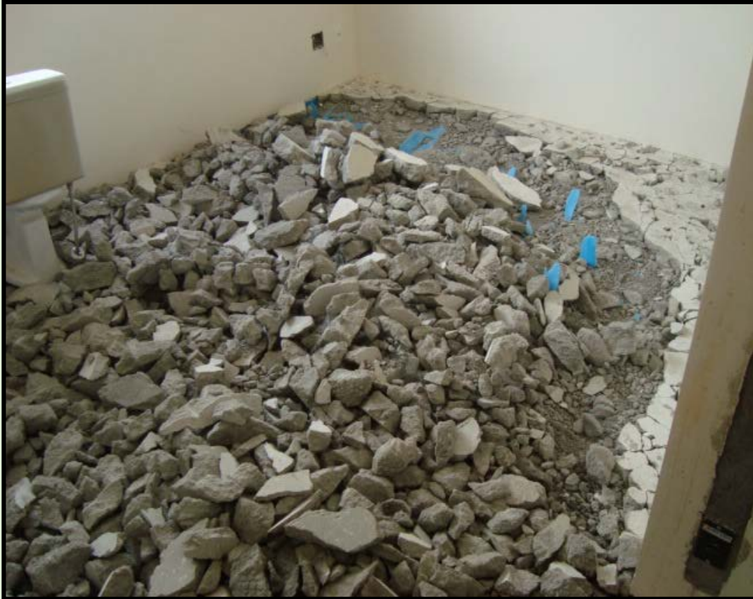
Contrapiso acústico destruído pelo proprietário
