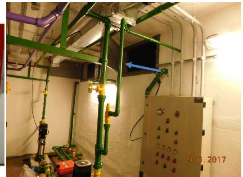
1 – 2º subsolo comercial - Sala de bombas - As tubulações verticais necessitam de fixação; não identificação das tubulações.
