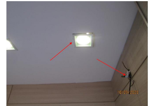
Uma das luminárias que precisam de reparo, possível notar na fotografia fios e drenos expostos.
